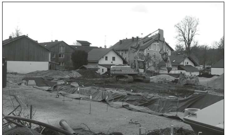
Die Erschließungsarbeiten am Postanger sind in vollen Gange, die ersten Bauanträge wurden bereits eingereicht. Foto: Stephan Kreuzer
