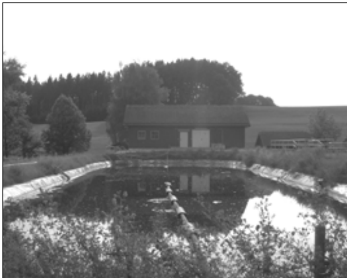
Die Glonner Kläranlage ging 1996 in Betrieb, mittlerweile sind fast alle Ortsteile angeschlossen. Foto: sk
